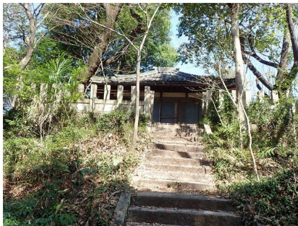
写真 劣化が進む太子堂
