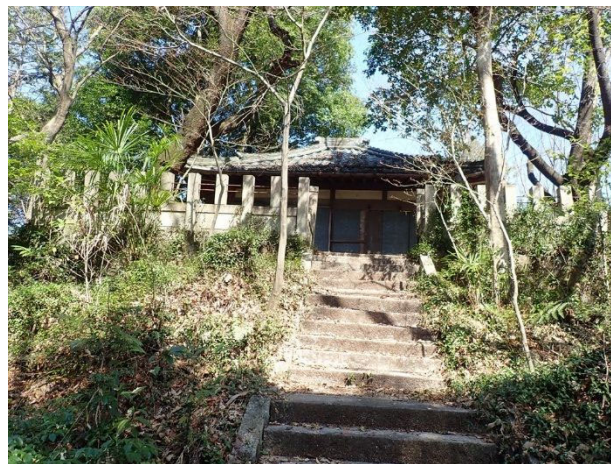
写真 劣化が進む太子堂
