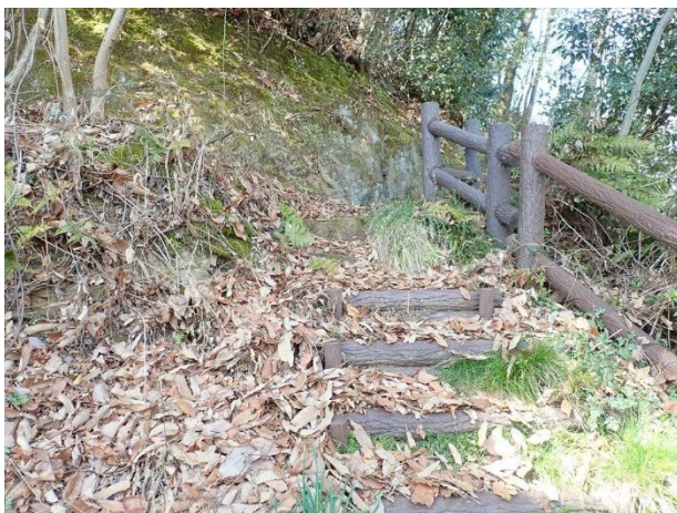
写真 劣化した階段工
