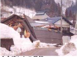
↑全壊した公民館
