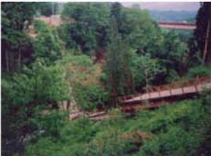
↑落下した中条橋
